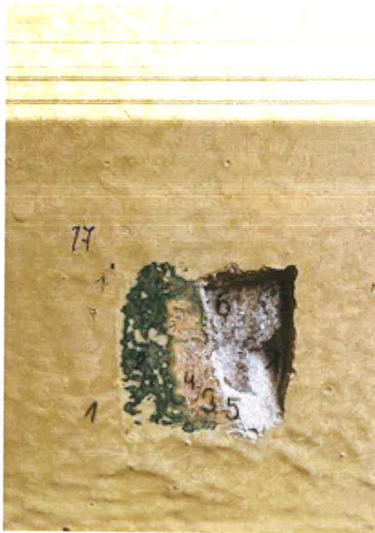
16 nawa główna/ lewa kolumna przy wejściu głównym, odkrywka w możliwie najwyższym punkcie, ok 220 cm od podłogi
